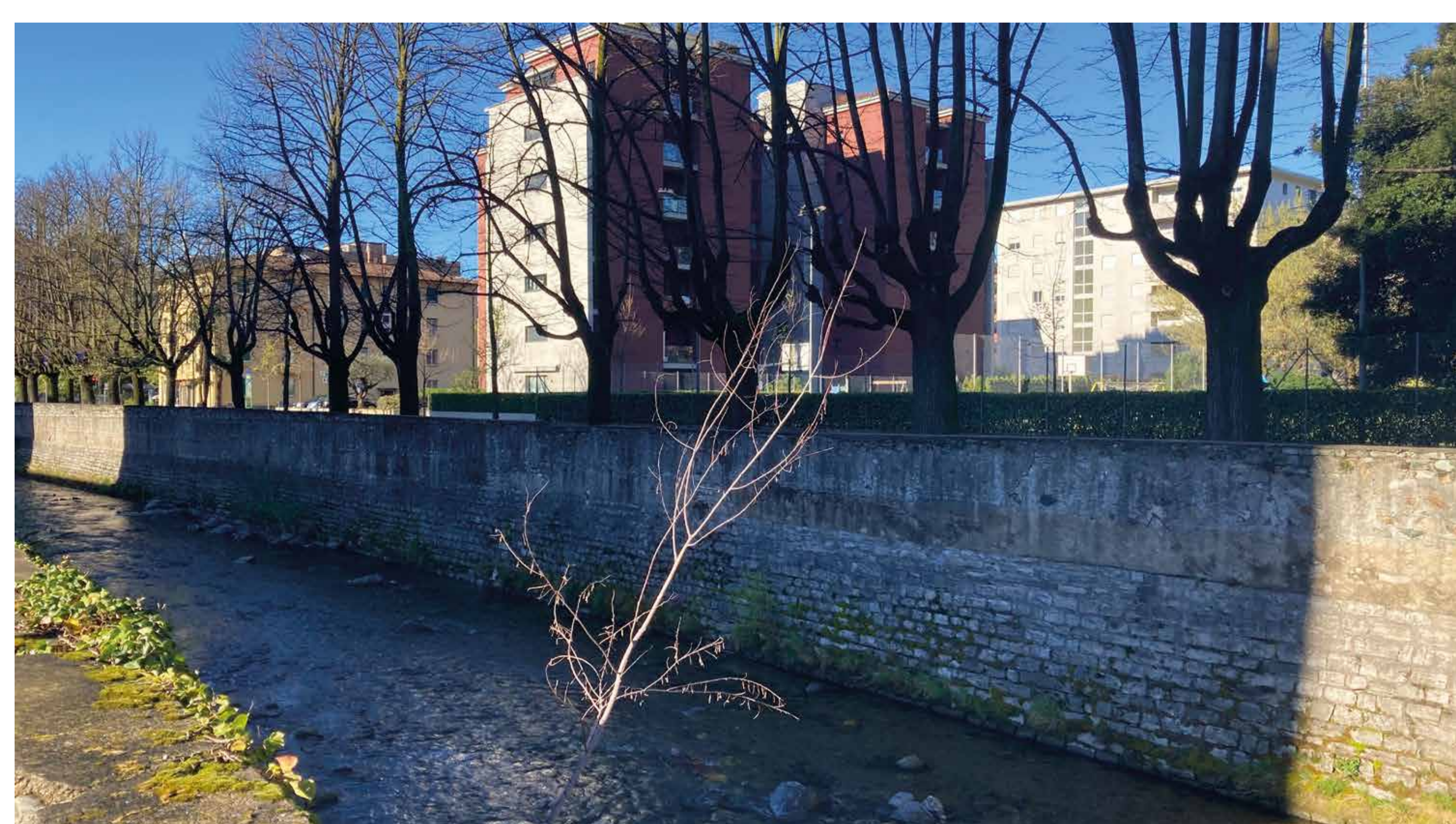
Muro di argine sul quale si propone di creare un murales con materiali riciclati (Foto di: Ilaria Sirvinskaja)
